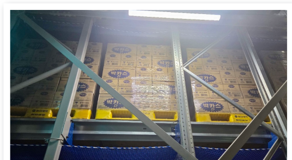
자동화 창고에 설치된 추락 방지망
